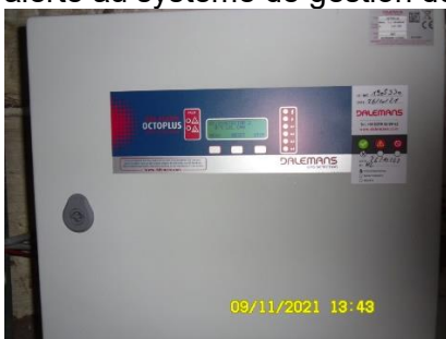
centrale de détection de gaz
