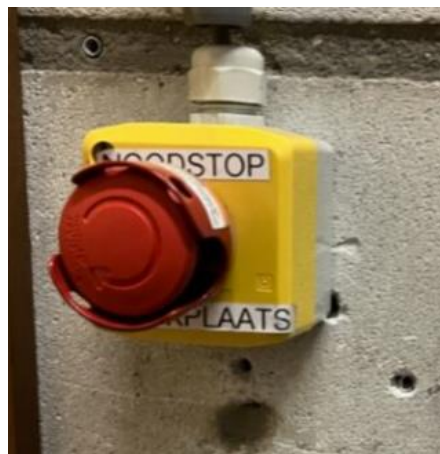
Vanne d'arrêt d'urgence de la chaufferie
