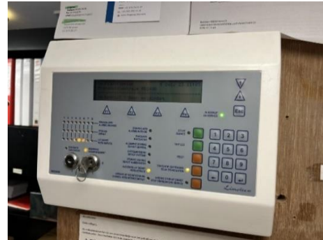
Centrale de détection incendie
