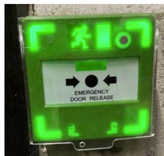
Déverrouillage de porte (local technique au-dessus de la salle de théâtre)
