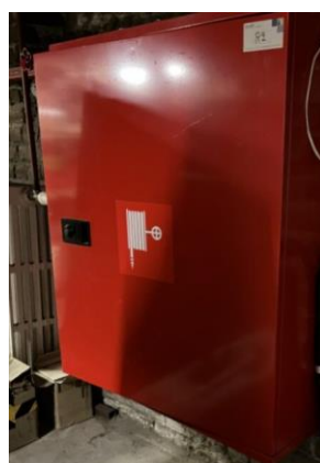
Raccord d'incendie avec tuyau (RIA) dans armoire
