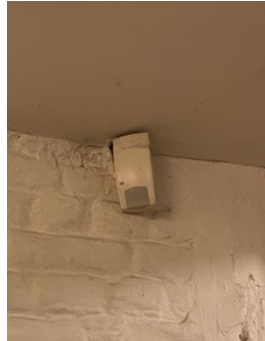
Capteur du système d'alarme
