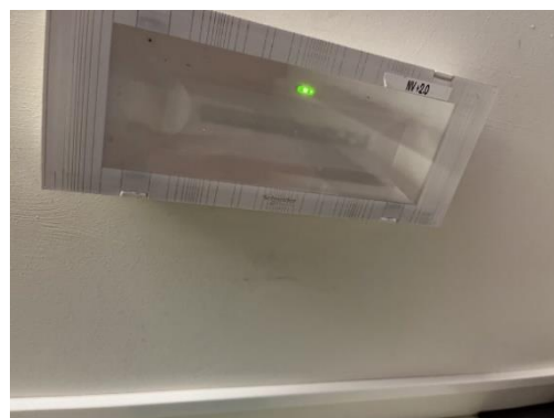
Luminaires autonomes d'éclairage de secours (s'activant en cas de coupure d'électricité)
