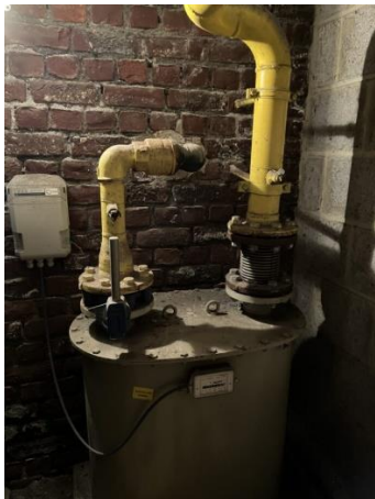
Vanne principale de gaz
