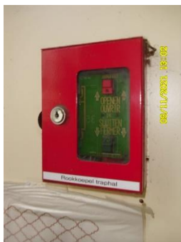
Commande de trappe de désenfumage
