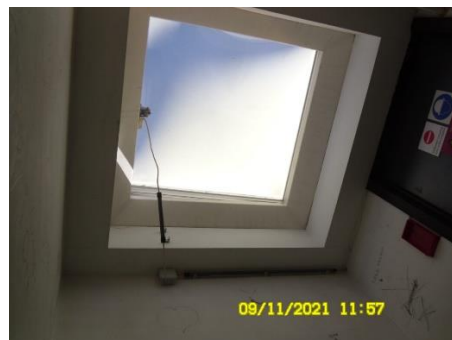
Trappe de désenfumage
