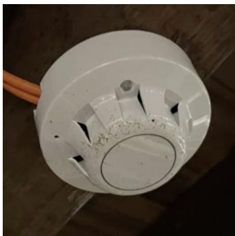
Détecteur de fumée
