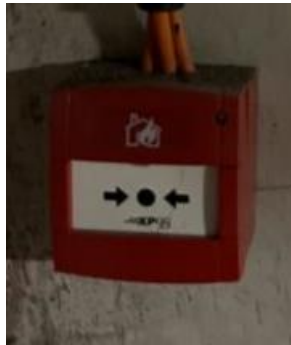
Déclencheur d'alarme incendie
