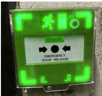
Deurontgrendeling (technische ruimte boven theaterzaal)
